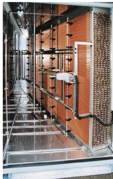
Blick auf die Wärmetauscher mit Kupferlamellen des hybriden Rückkühlsystems Hybricool. Die VDI Richtlinie 2047 Blatt 2 «Sicherstellung des hygienegerechten Betriebs von Verdunstungskühlanlagen» kann so ohne aufwändige Wasserüberwachungen erfüllt werden.
